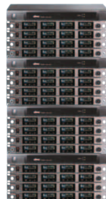
Bild 3C: Sechzehn MIPRO ACT-74 4-Kanal Empfänger die über vier AD-707 Antennensignalverteiler versorgt werden.
